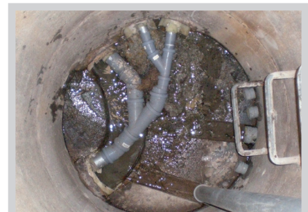
Anbindungen im Schacht
